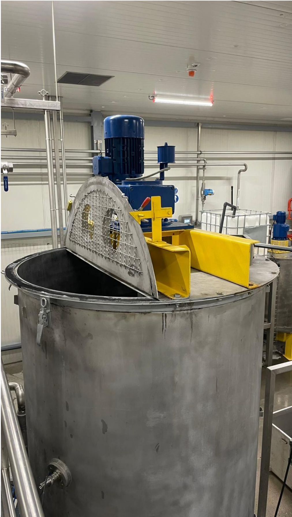
Zdjęcie 5. Właz zbiornika
